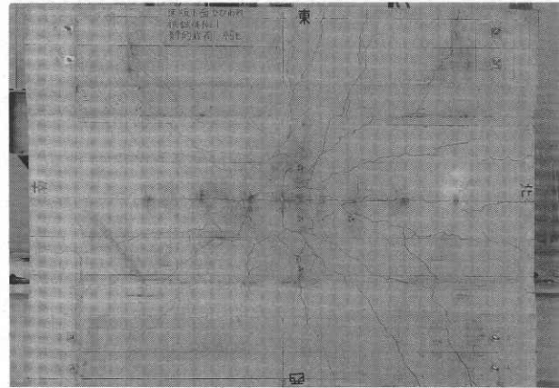
図3 載荷後の供試体下面ひび割れ状況(二辺支持)
