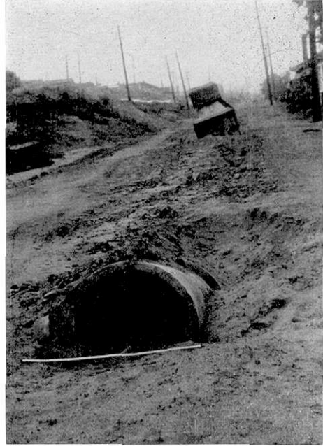
第7図 新潟市川岸町附近 下水道の被害，マンホールの浮出し。
