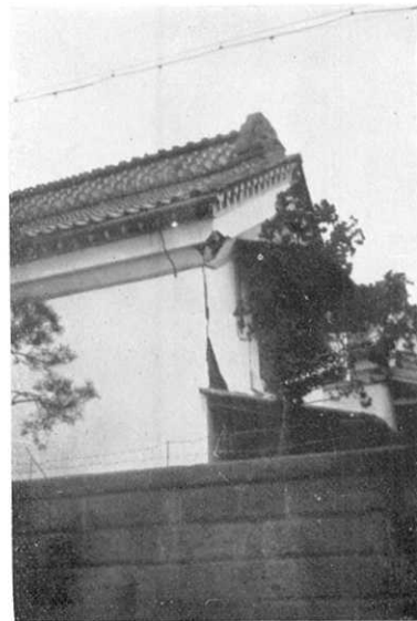
第 8 圖 石巻市 塗り替へた土蔵の壁の角の損傷
