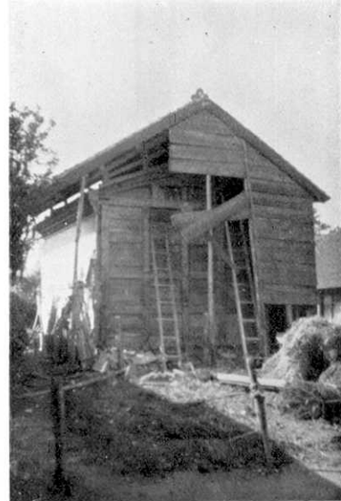
第 6 圖 尾濱村 古い土蔵の壁の剥落
