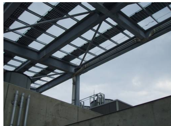
PVシェルターと架台
