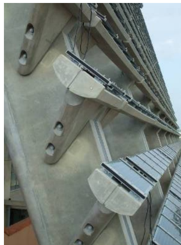
南面 PV ルーバー
