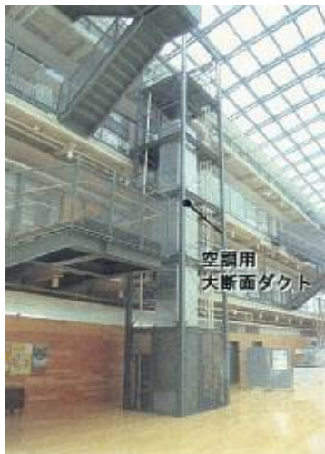
地下ピットからの給気ダクト
