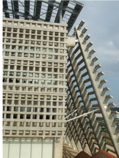
南面PVルーバー
