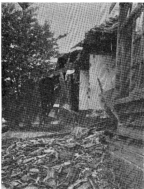
寫真 第四七 對居山港西小學校正面被害
