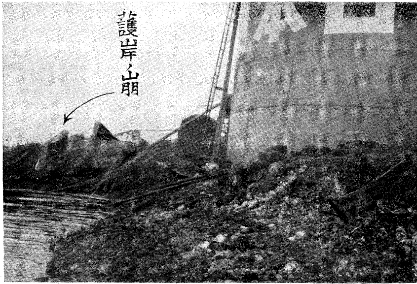
第一圖 護岸及重油槽ノ破壊
