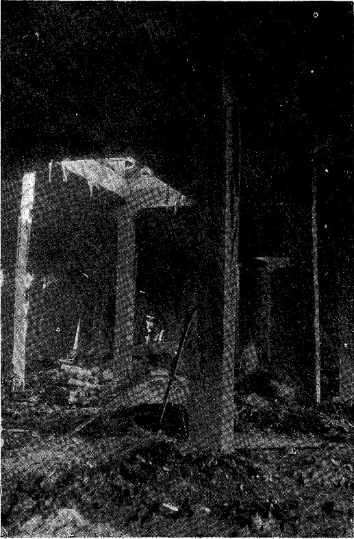
新港町三井物産株式會社倉庫 鐵筋「コンクリート」平家建 地盤龜裂ノ爲壁體・柱・屋 根等大破損
