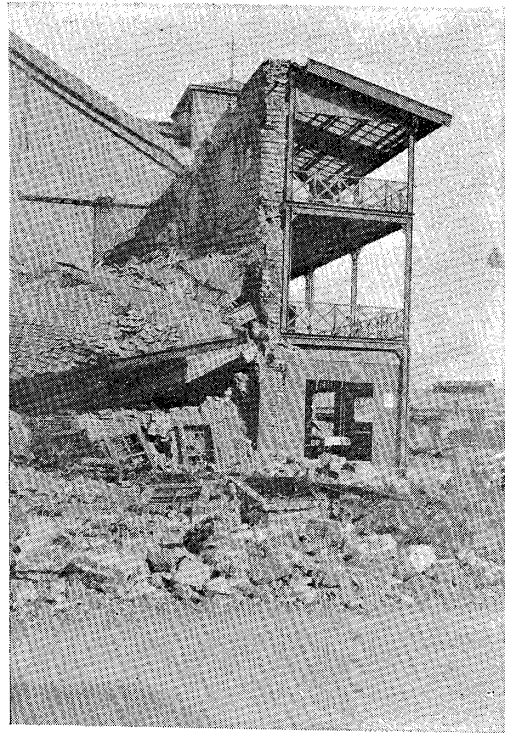
寫真第一一 新港町稅關倉庫 煉瓦造三階建 煉瓦壁ノ崩壞
