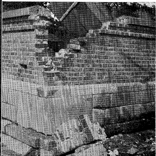
寫眞第一一 麴町區五番町英國大使館 煉瓦塙壁崩壞ノ狀況
