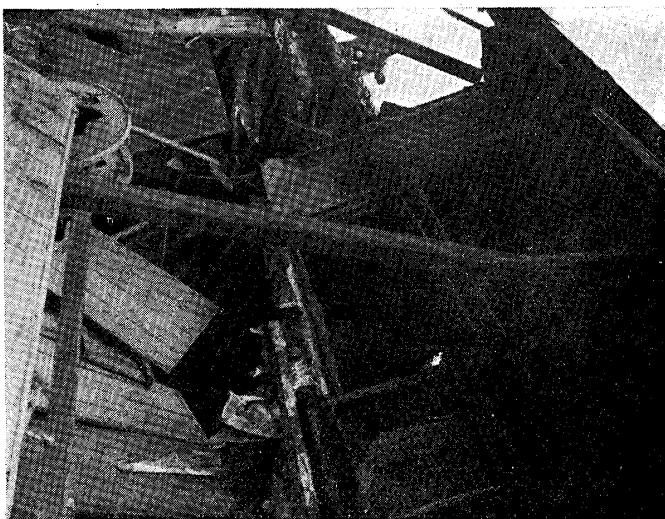
寫真第一〇五 小石川區小日向町五七 下家取付部折損 北々西ノ約二十五度傾斜又
