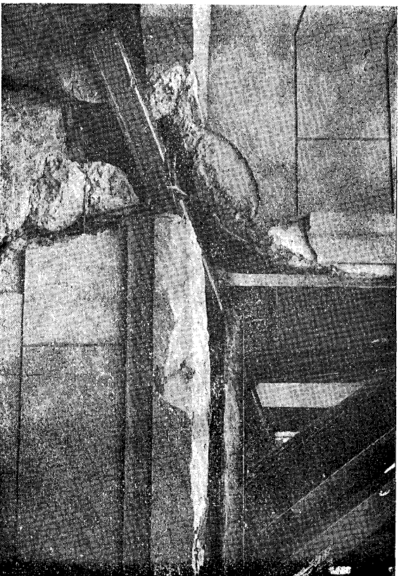
No. 166 寫真第一六六 同上 窓際破壊ノ狀況
