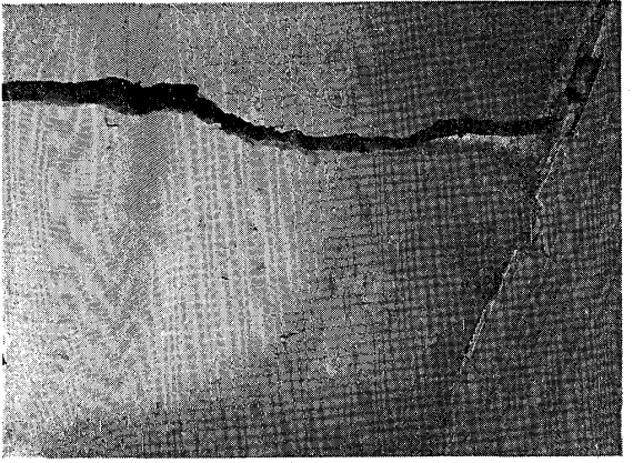
寫真第一七九 四谷區忍町 麹町銀行四谷支店 二階應接室間仕切壁ノ垂直龜裂
