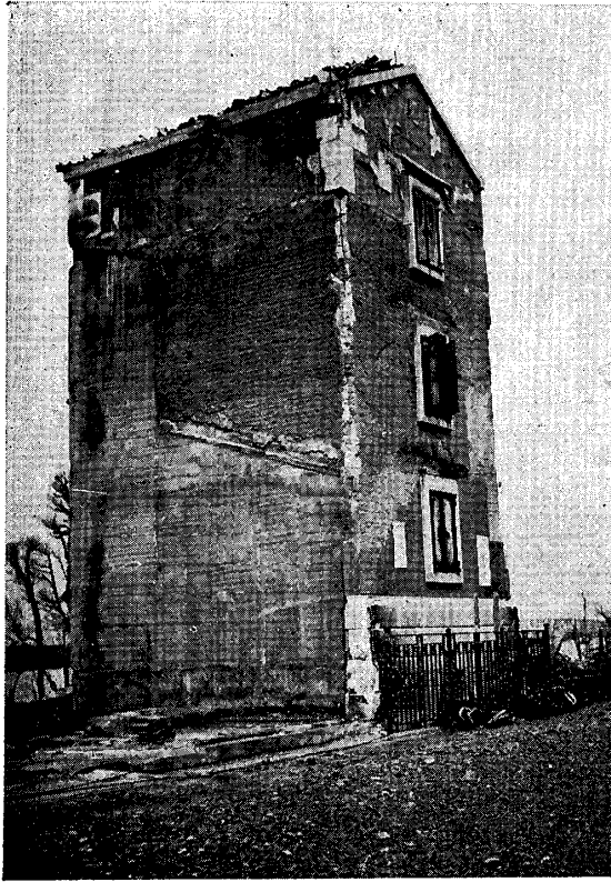
火耐ノ屋家造木リ張石火抗 圖九十四第 (難無ハ部内)力能
