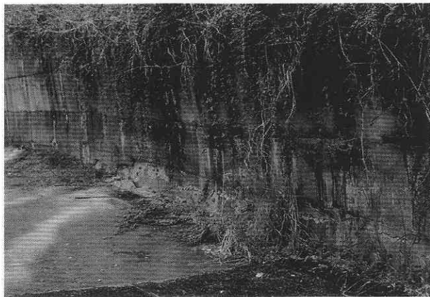
写真3 集集地震で壁体が曲げ破壊した重力式擁壁
