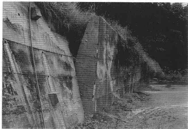
写真1 集集地震で前傾した重力式擁壁とこれに隣接する無被害のアンカー式擁壁
