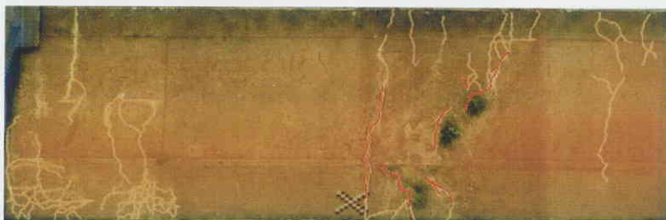
図 10 重ね合せ図 (原画像+ひび割れ+赤外線)
