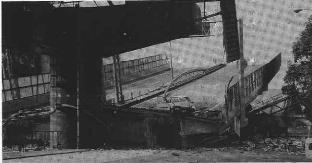
写真 1 橋桁 S3 および S4 の落橋
