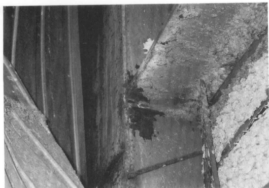
写真4 柱梁溶接接合部の破断 (西宮市N専門学校, 井上一朗 阪大助教授提供)
