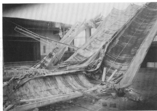
写真5 シェル梁の落下 (西宮市KT小学校)
