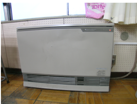
普通教室 a-I、a-II (ガスファンヒーター)
