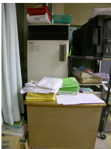
普通教室 g (ガスファンヒーター)
