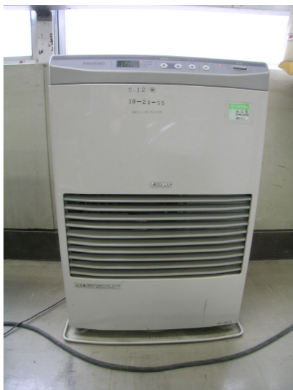
←指導室 A（石油ファンヒーター）
