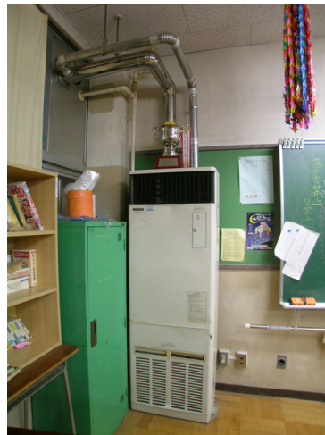
普通教室 b (ガスファンヒーター)
