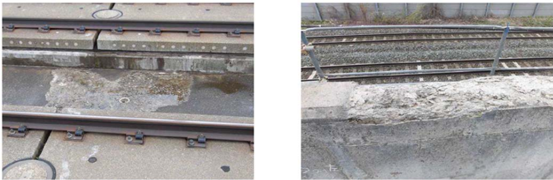
写真 2.2.1 スラブ上面、防音壁天端のスケーリング状況
