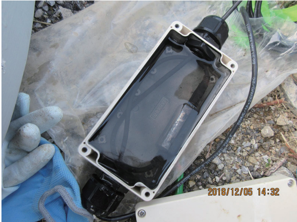
図10. 水没した1号機のUSBリピータ。2018/12/05の保守時に、当該装置を取めたケースを開けた直後の様子を撮影したもの。ケースが雨水で満たされている。水没した状態でしばらく通電していたためか、腐食が激しい。
