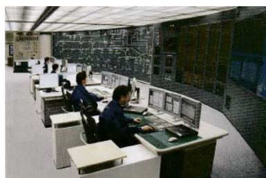
図 1-8 中央給電指令所[5]
