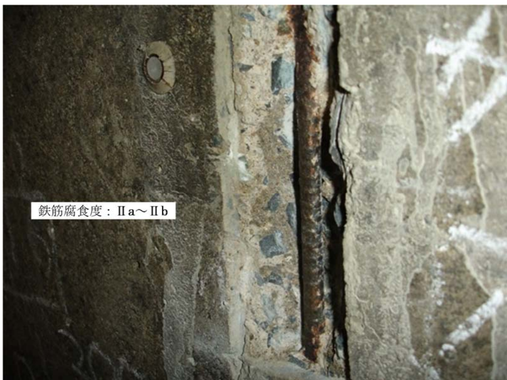
写真 2.5.7 はく離箇所での鉄筋はつり出し
