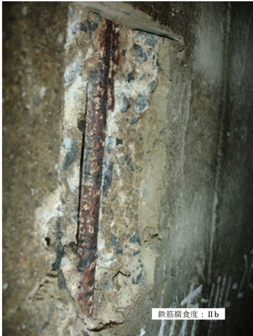
写真 2.5.5 ひび割れ箇所の鉄筋腐食
