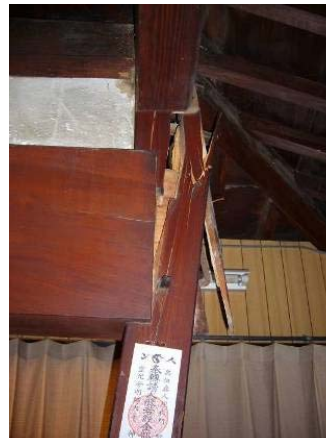
(d) 柱の折損
