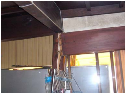
(a) 柱－差鴨居接合部の破壊
