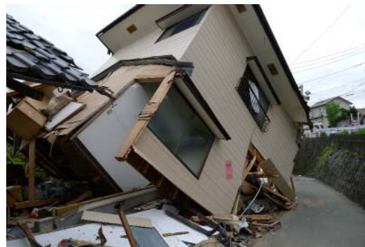
写真 3.1.2 接合部の先行破壊による転倒
