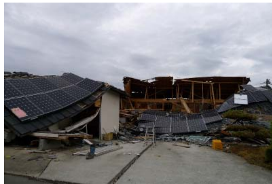
写真 3.1.4 水平構面（小屋組）の破壊
