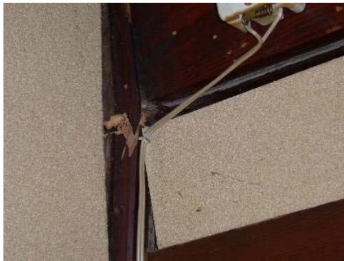
(c) 柱－差鴨居接合部の破壊
