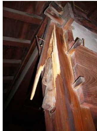
(b) 柱－差鴨居接合部の破壊
