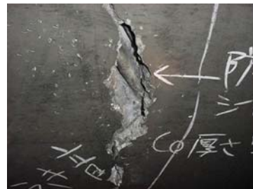
写真 2.2.3 防水シートによる巻厚不足 1)
