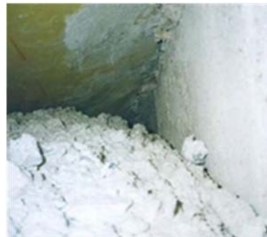
写真 2.2.2 覆工妻部空洞状況 1)
