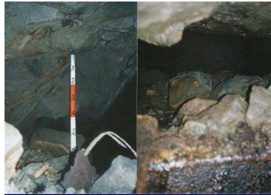
写真 2.2.1 覆工背面の空洞状況 1)
