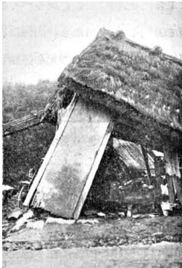
第 133 圖 土臺の無い建物 の被害 例 1 (京都府口大野村 某農家)
