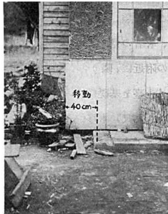
第 142 圖 土臺が移動して倒 れなかつた建物 (静岡縣菟山村 某理髮店)
