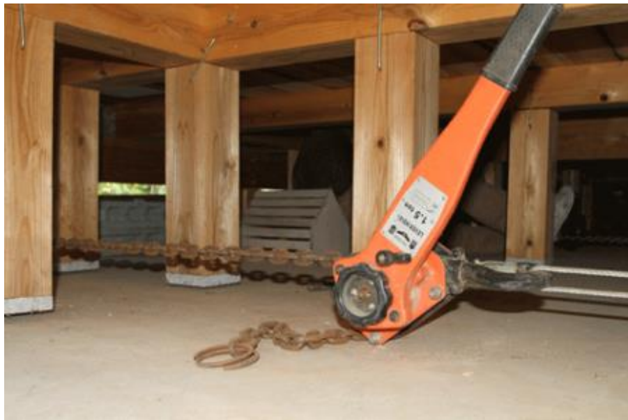
図 4.9.7 伝統構法住宅のレバブロックによる『曳き家』（写真：文献 66) から一部引用）
