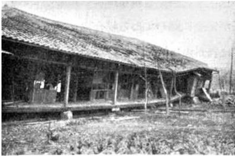
第135圖 土臺の無い建物の被害 例3 (静岡県韭山村 某病舎)
