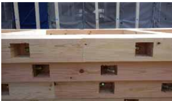
下弦材継手部(引張ボルト)
