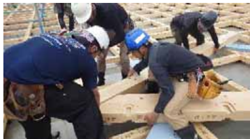
トラス地組み⇒加工間違い中止 (2)
