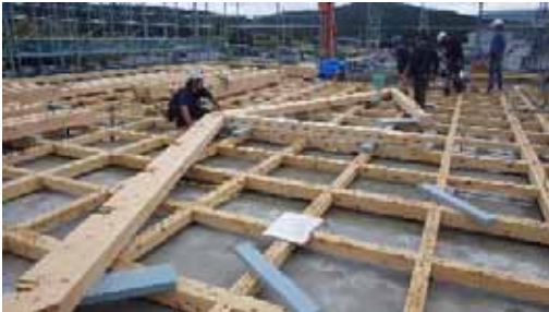
トラス地組み⇒加工間違い中止
