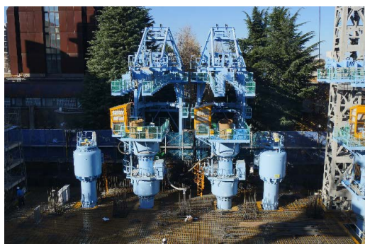
地下で掘削した土を地上へ排出する設備
