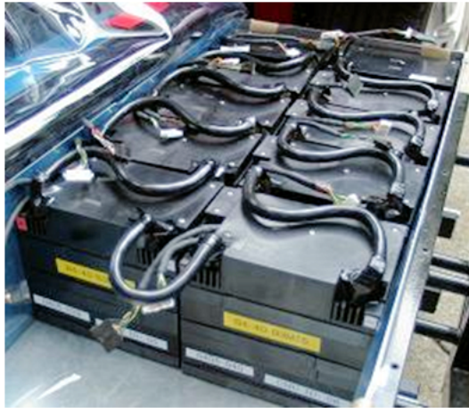
Fig. 17: FPEV2-Kanon のリチウムイオン電池
