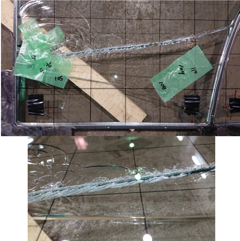
Fig.2.31 ガラス4の亀裂詳細図(上：全体図，下：拡大図)
