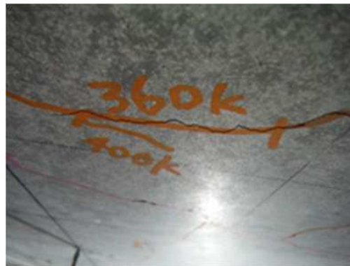
写真 6-3 段差を伴うひび割れ (軽量 RC-20' )
