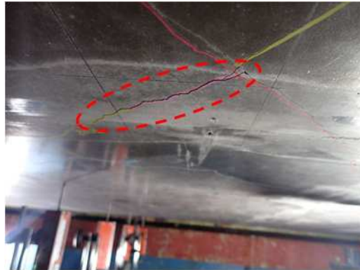
写真 6-2 段差を伴うひび割れ (軽量 RC-0)
