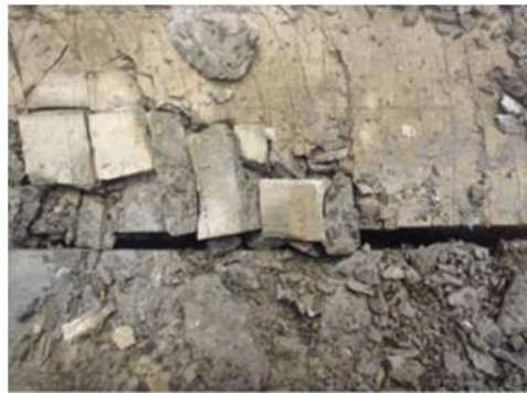
写真 1-8 供試体上面破壊状況（膨張材併用軽量 RC 床版）
