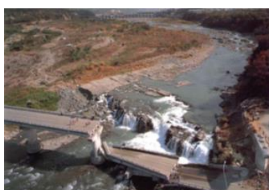
図 2.2.1-7 Bei-Fung 橋の崩壊[13]
