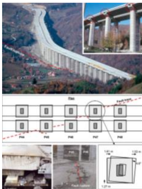
図 2.2.1-8 Duzce-Bolu 高架橋の被害[13]
