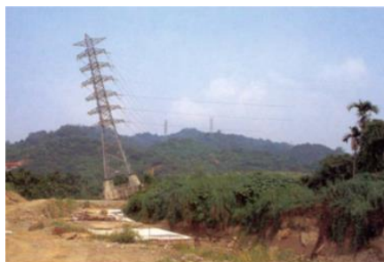
図 2.2.1-5 鉄塔基礎の被害[13]
