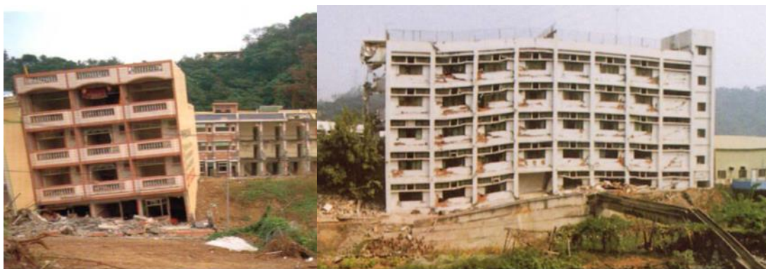
図 2.2.1-4 RC 建造物の被害 (左：剛基礎支持，右：柔基礎支持) [13]
