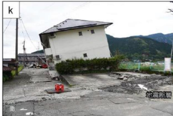
図 2.2.1-11 2016年熊本地震における断層変位による建物の損傷[14]
