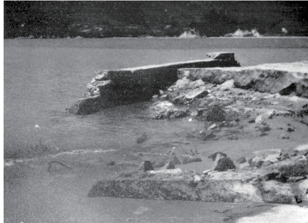
図 7-9. 田の浜集落における昭和三陸津波による護岸堤防の被害
