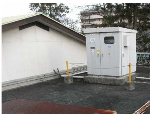
部分的に更新されている受変電設備・更新が必要な屋上 (施設 A)
