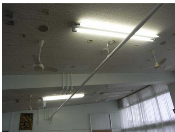
既存空間に配慮し、塗装された SP 配管 (施設 A)
