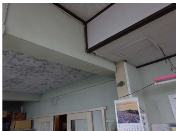
漏水が発生した作業室室内屋根（補修済） （施設 A）
