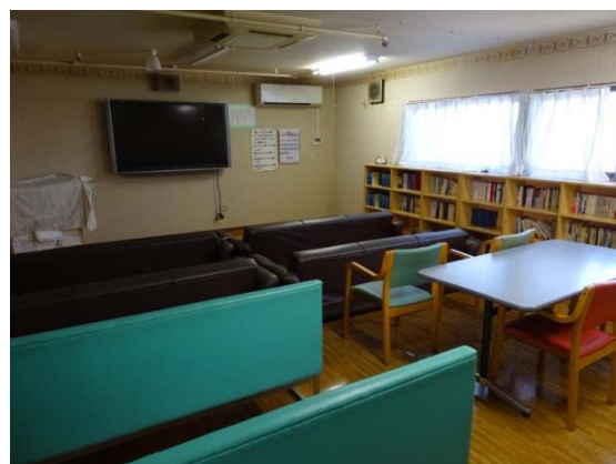
スプリンクラー配管が露出した談話室 (施設 B)
