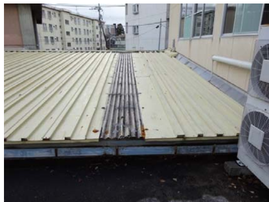
劣化が進んでおり漏水が懸念されている屋根 (施設 A)
