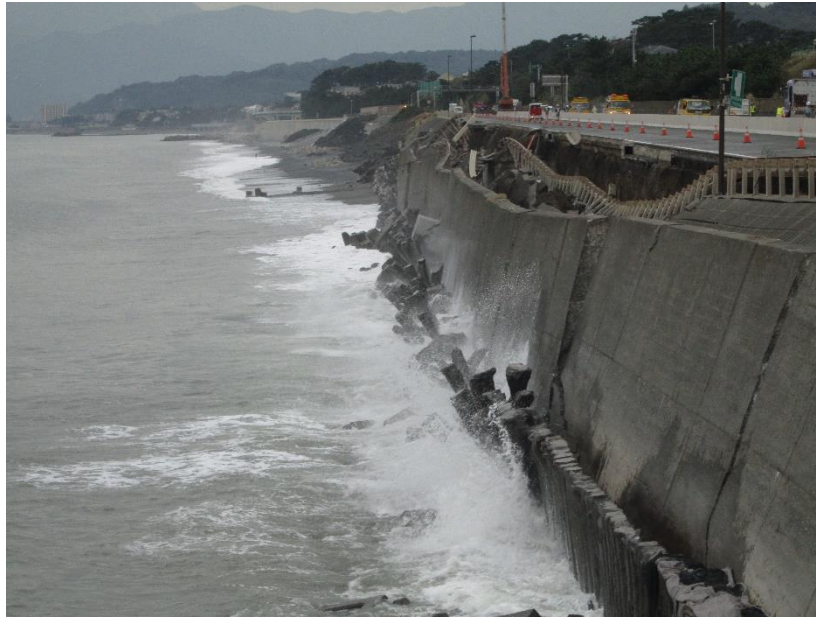
図 4.11 被災した西湘バイパスの擁壁 (提供：国土交通省関東地方整備局)
