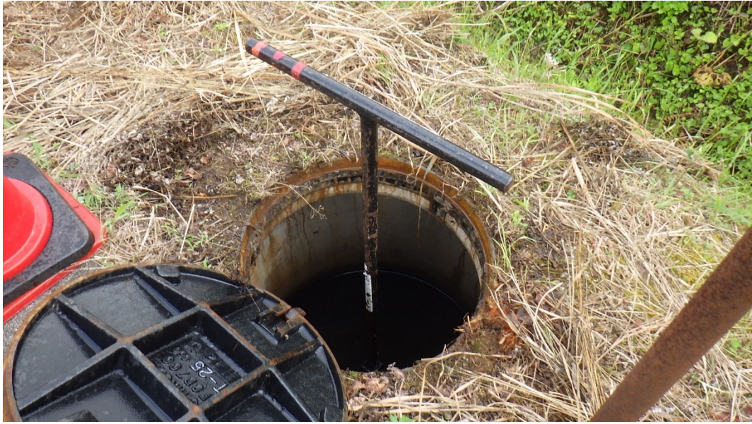
写真 4-6 排泥弁を開けている様子
