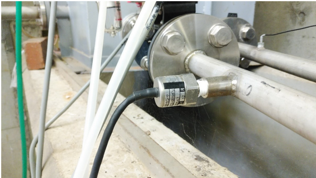
写真 4-3 下流端バルブ直上流に設置された圧電素子型圧力計（東京計測社製）
