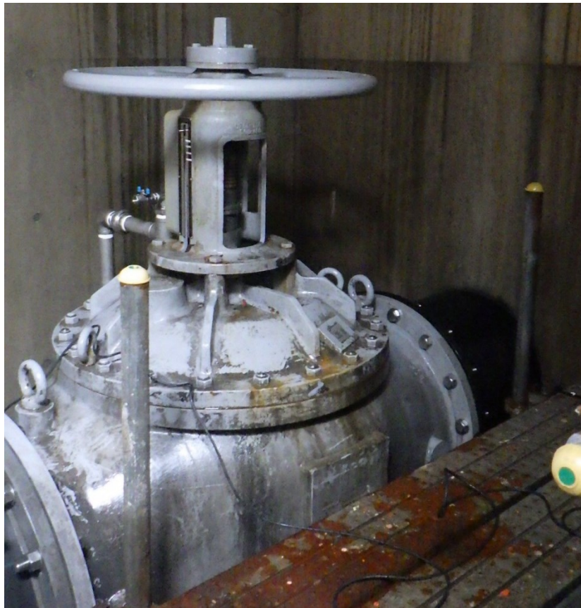
写真 4-4 新保注水工の制水弁（ユニフロー弁）
