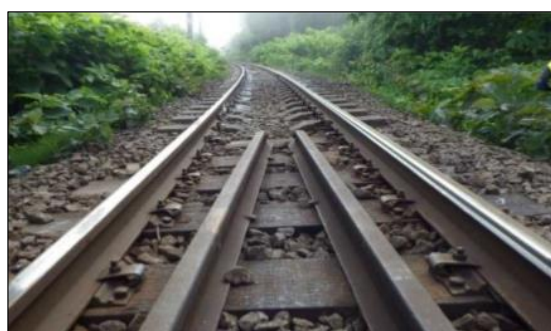
(a) 脱線事故現場付近の曲線
