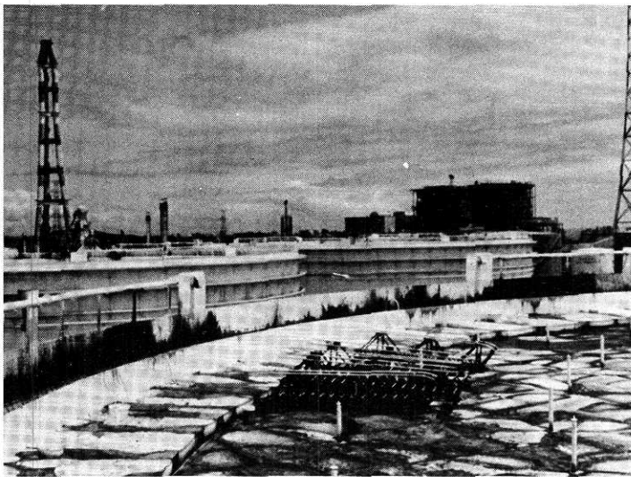
写真32 東北石油 T-2, 噴油状況。ラダーは破損して、 取り外してある
