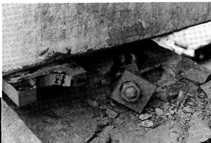
▲ 写真22 桁の沓座の被害 (新幹線高架橋)
