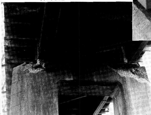
▼ 写真21 橋脚頂部の支承部の破壊 (木間塚橋)
