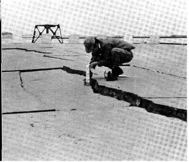
▲写真40 相馬港第一埠頭の被害 本文図12の第一個所(福島県土木部提供)
