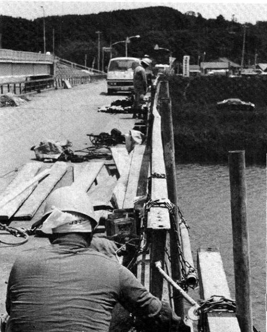
▼ 写真17 桁の移動で橋の線形が曲った小野橋(鳴瀬町)
