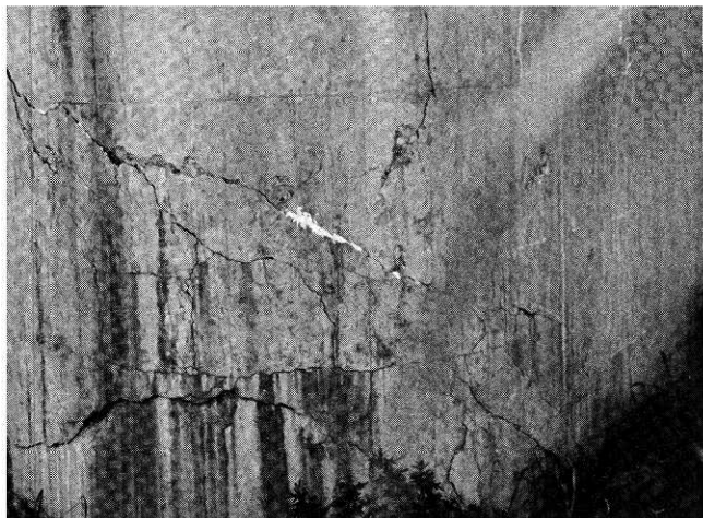
▲ 写真19 コンクリート橋脚に生じた亀裂 (関上大橋)
