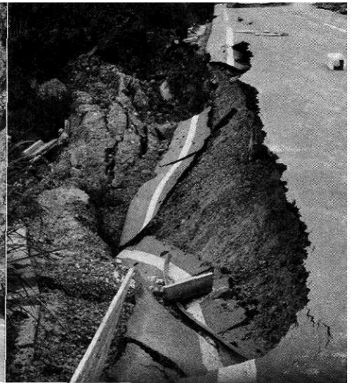
▲ 写真14 泉市南光台における盛土部 路肩崩落
