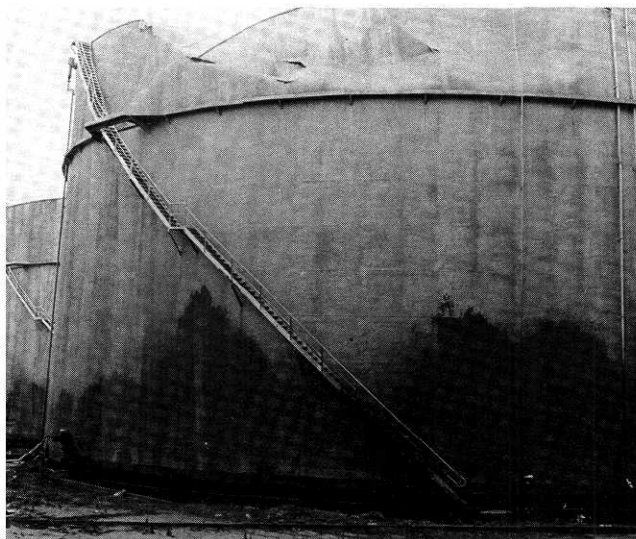
▲ 写真34 底部の破断したタンク (手前よりT-217, T-218タンク, 東北石油)
