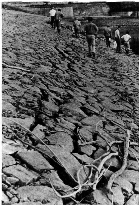
▲写真25 牛野ダム（ロックフィルダム）では上流法面の表層の捨張石が沈下した
