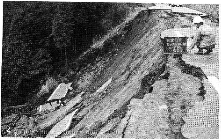
4 別府阿蘇道路の崩壊(日本道路公団提供)
