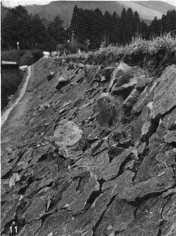
11 上流側張石のすべり (九州電力提供)
