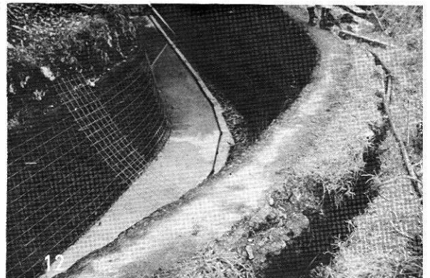
12 水路と盛土の間に生じたすき間
