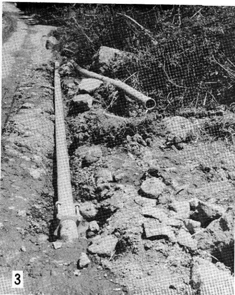
3 湯平地区の送水管の被害と復旧した管
