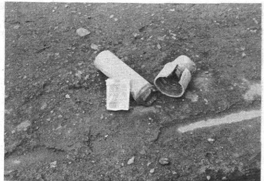
写真-7 铸铁管継手部の破損
