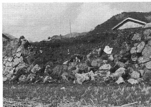
写真-3 石垣の崩壊
