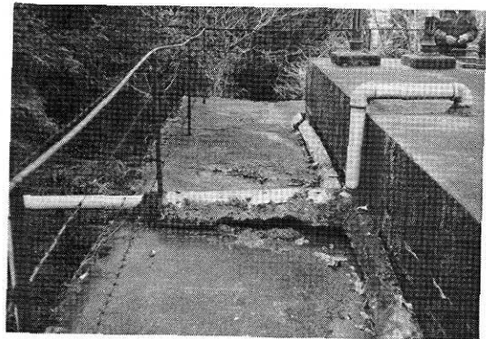
写真-5 配水池の被害状況
