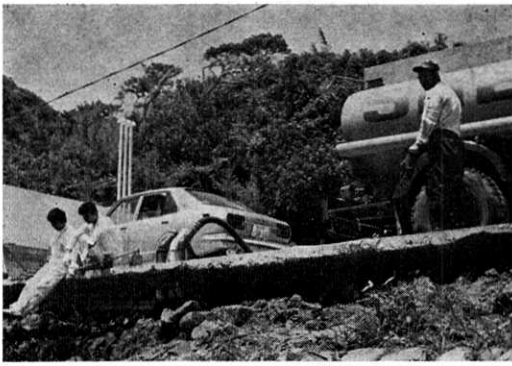
写真5 入間地区のガソリン給油所、石垣が崩れたため、タンクローリーよりの給油受入管が露出している。床版に加った荷重がさらに配管に加る可能性もある。
