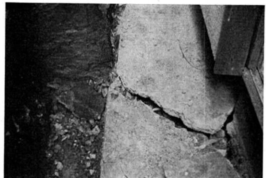
写真2 写真1の断層が地面に接するところ。土間のコンクリートにはそれだけの変形はなく、左側のがけにのみ変位がみられる。
