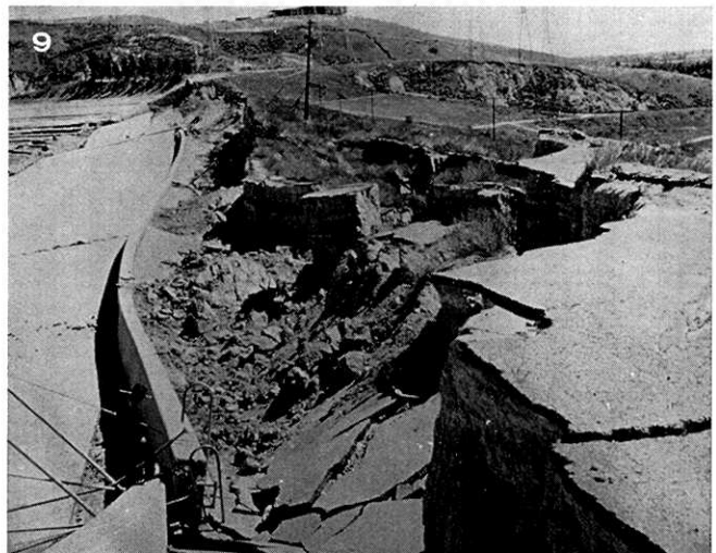
9. Lower San Fernando ダムの右岸側より見た破壊状況で、堤体には堤軸直交方向にも多くの亀裂が見られる。上流法面保護のための厚さ約 20 cm の鉄筋コンクリート版は、鉄筋が切断して開口したり、あるいは挫屈のごとき破壊を示していた。 (撮影 田村)
