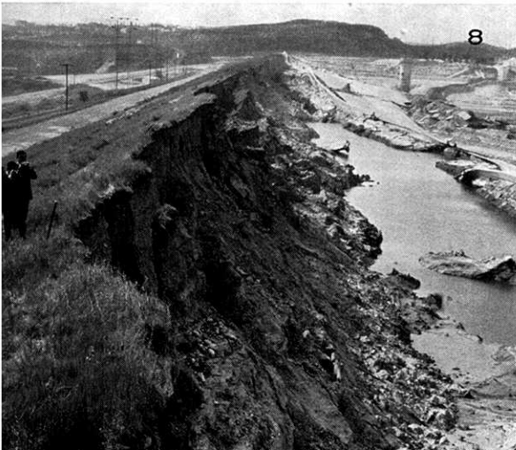
8. Lower San Fernando ダムは水締工法によって建設されたもので、高さは約 40 m であって、湛水側に滑動崩落した。湛水位より数フィート上で滑ったため、越流崩壊をまぬかれた。 (撮影 田村)
