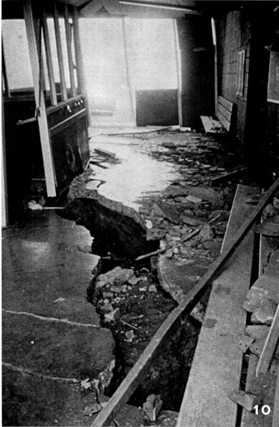
10. Juvenile Hall には多くの地割れがあって、その上の建築物や道路は著しい被害を受けた。(撮影 田村)
