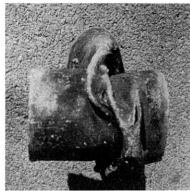
写真 4 分岐部(チーズ)が圧挫したガス管(8"φ) (電々公社杉田氏の好意による)。
