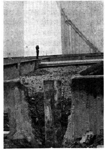
③ 防油堤の損壊
