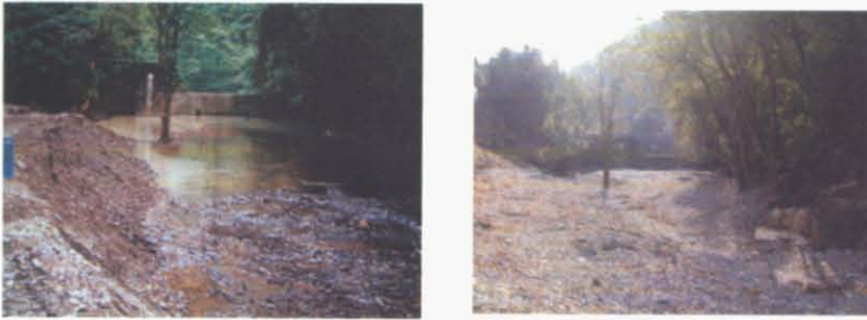
写真 4-1 土砂で埋没した河川と水源地(写真左は掘削作業後、右は再度堆積する現在)
