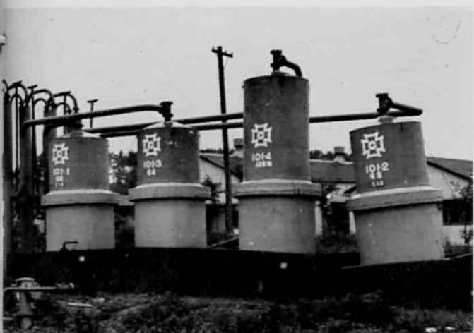
③ 基礎工事のかんたんな小型のタンク、塔槽類、圧縮機、ポンプは個別に動いて傾いた。
