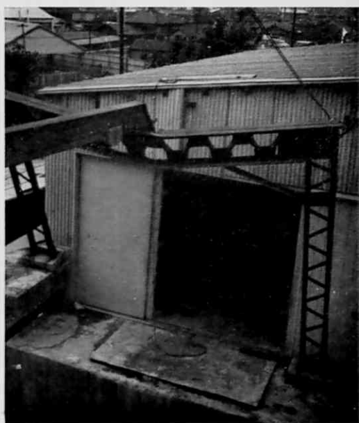
④ 建物に剛に連結されているものは被害が大きかった。これはクレーン・レーズの例。
