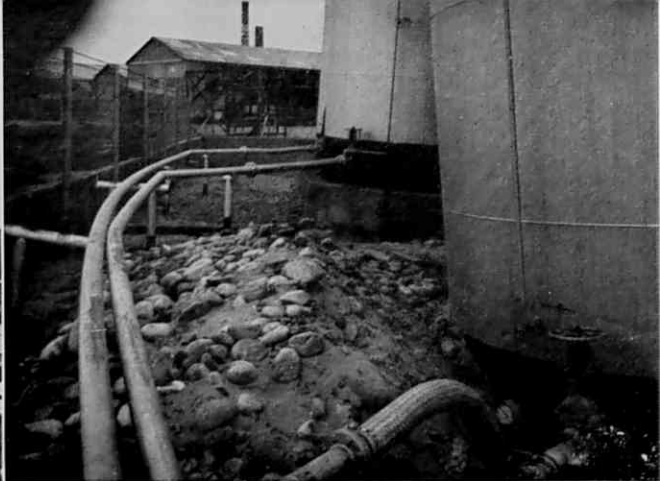
② タンクと配管との取付けに可撓管を使うと有効である。手前は沈下による食い違いを、後の二つは横の移動による破断を逃れている。
