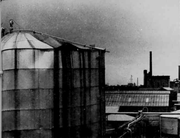
① 油の共振に伴う衝撃により、天井鏡板と側板との間が破れた例、ピョウ締め構造のため、ゆるんで漏油したあとが見える。
