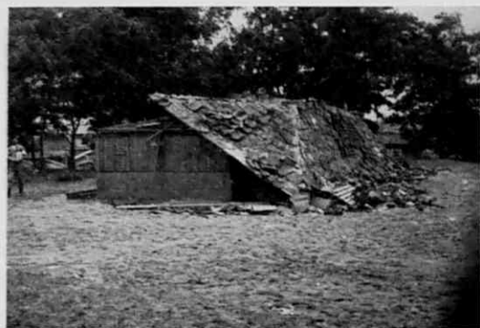
写真2 諏訪神社神楽舞台 瓦拵きの屋根を支える柱が折れた
