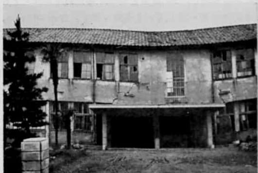
写真6 県警察学校(木造モルタル) 中央部の陥没によってせん断破壊
