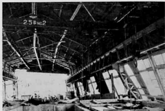
写真5 某プレコン工場 柱脚が右方(信濃川方向)へ移動した
