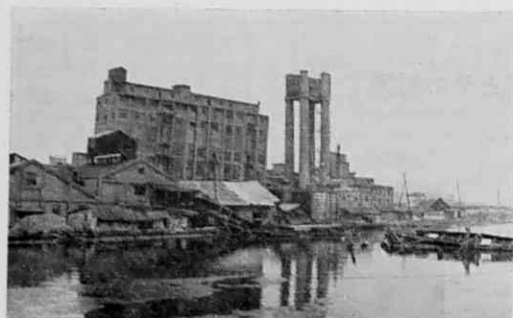
第 3.4 図 左側のコンクリート造の工場が全体として右に傾斜し、右の塔状物は左に傾斜している
