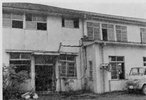
第 3・9 図 木造瓦ぶき二階事務所の被害
