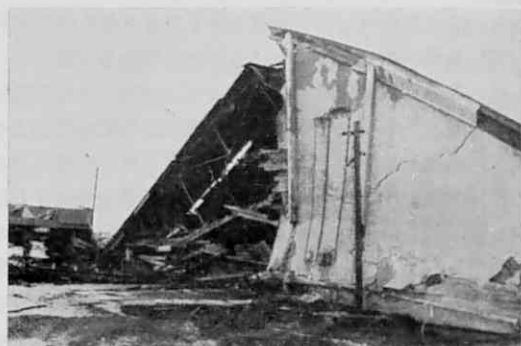
第 3・13 図 モルタル塗の外壁はこわれて 屋根の落ちた倉庫
