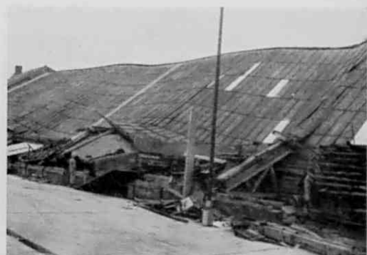
第 3・14 図 スレート等の屋根が全面的に 落下している
