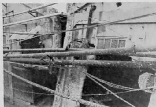
第 3.2 図 建物のつき目は大きく口があき配管類は切断あるいは屈曲している
