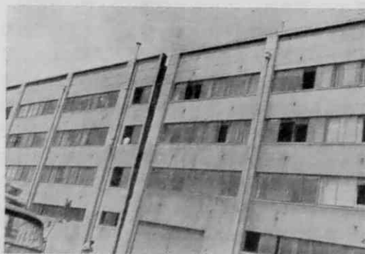
第 3.6 図 全面的に傾斜し、建増し部分で切断している。この傾斜によって隣接鉄骨車庫はかなり変形して被害をうけている
