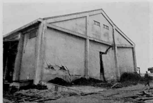
第 3・11 図 地盤の移動によって切断した コンクリート造倉庫
