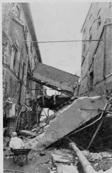
第 3.3 図 二つの建物をつないでいる廊下は脱落し、配管類は切断されている
