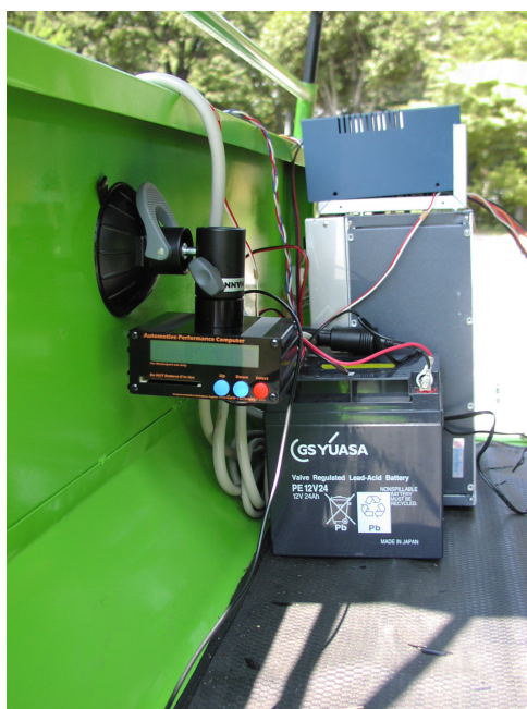
図 7.4 制御用コントローラ外観
