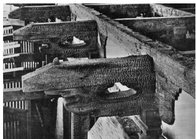
図 2-41 金堂初層尾垂木先端太枅 火災
