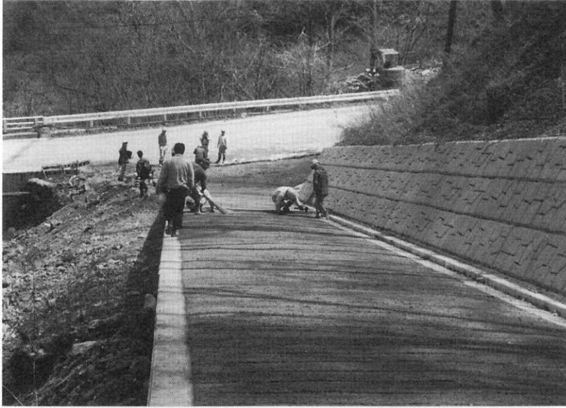
写真-3 コンクリートによる全面舗装。 Photo 3. Road-surface pavement with concrete.
