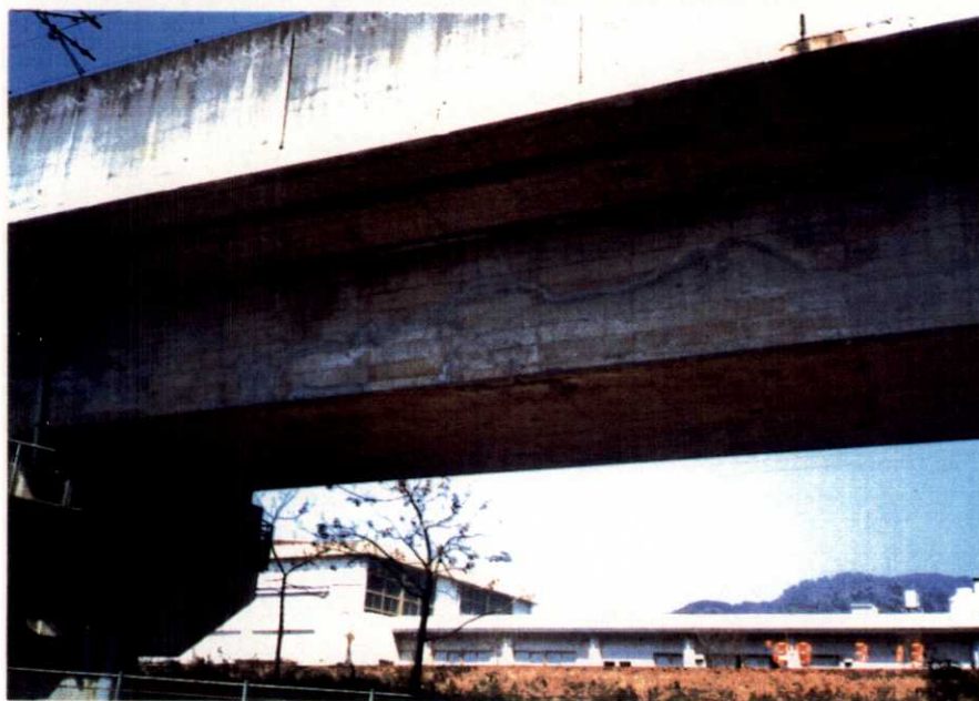
写真-5. 1 山陽新幹線PC箱桁コンクリート外観 (コールドジョイント)
