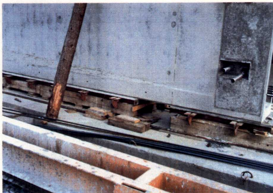
写真-4. 1 T桁フランジ部分拡大図（締固め不良部分）
