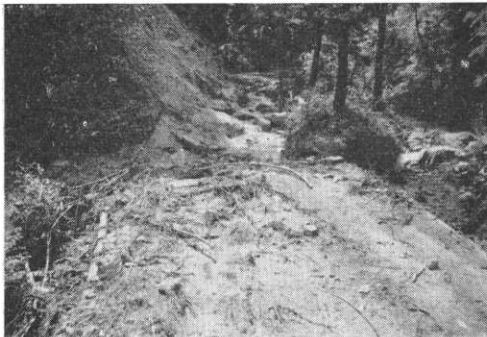
写真 5. 白坂団地：台風17号による林道流失
