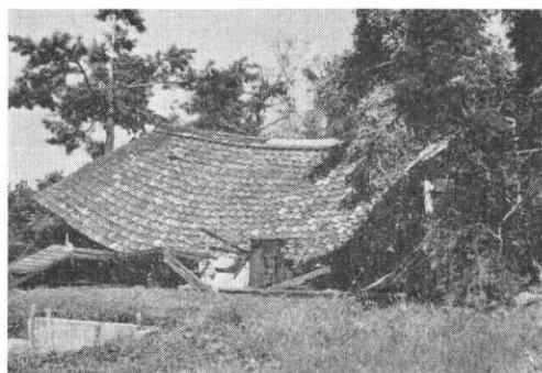
写真 8. 水野団地: 台風 15 号による倉庫倒壊
