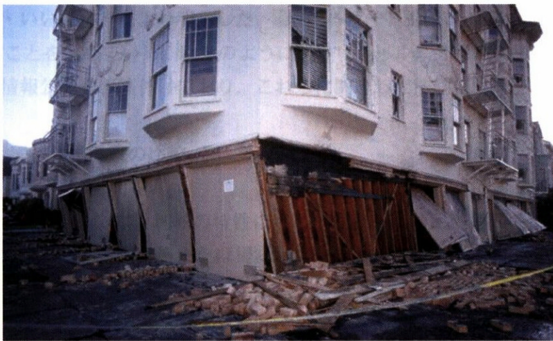
図 2-8 ロマプリエータ地震での木造共同住宅の被害例
